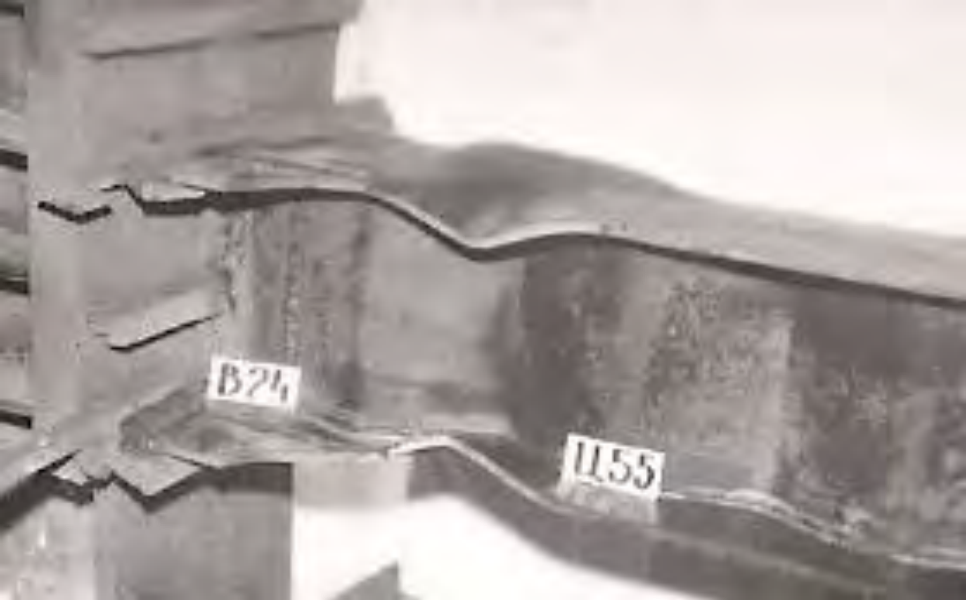
Характер разрушение гофрированной стенки при знакопеременном циклическом нагружении при гофрах с незначительной высотой волны и предельном свесе поясов
