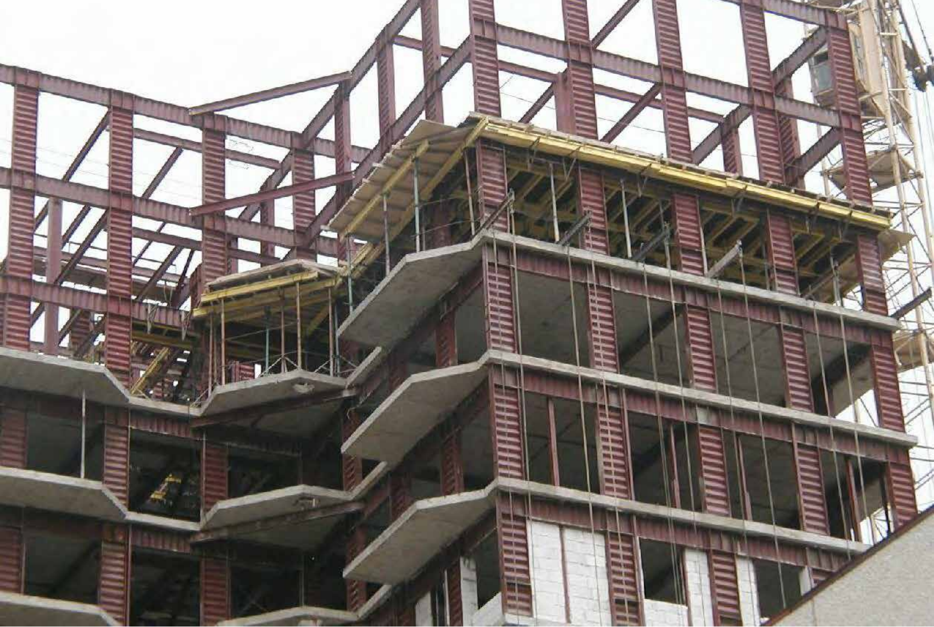
Фрагмент первого в мире стального каркаса многоэтажного здания (13 этажей) с колоннами и ригелями двутаврового сечения с гофрированными стенками
