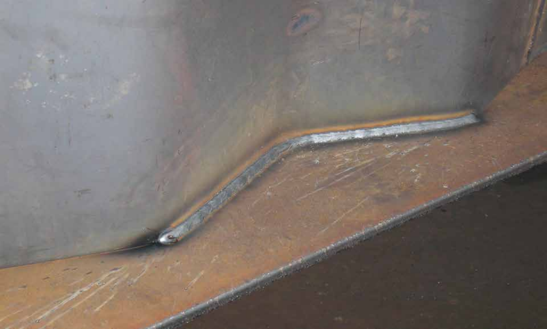
Фрагмент поясного шва балки с гофрированной стенкой сваренный полуавтоматом с применением аргона на заводе «Арсенал»
