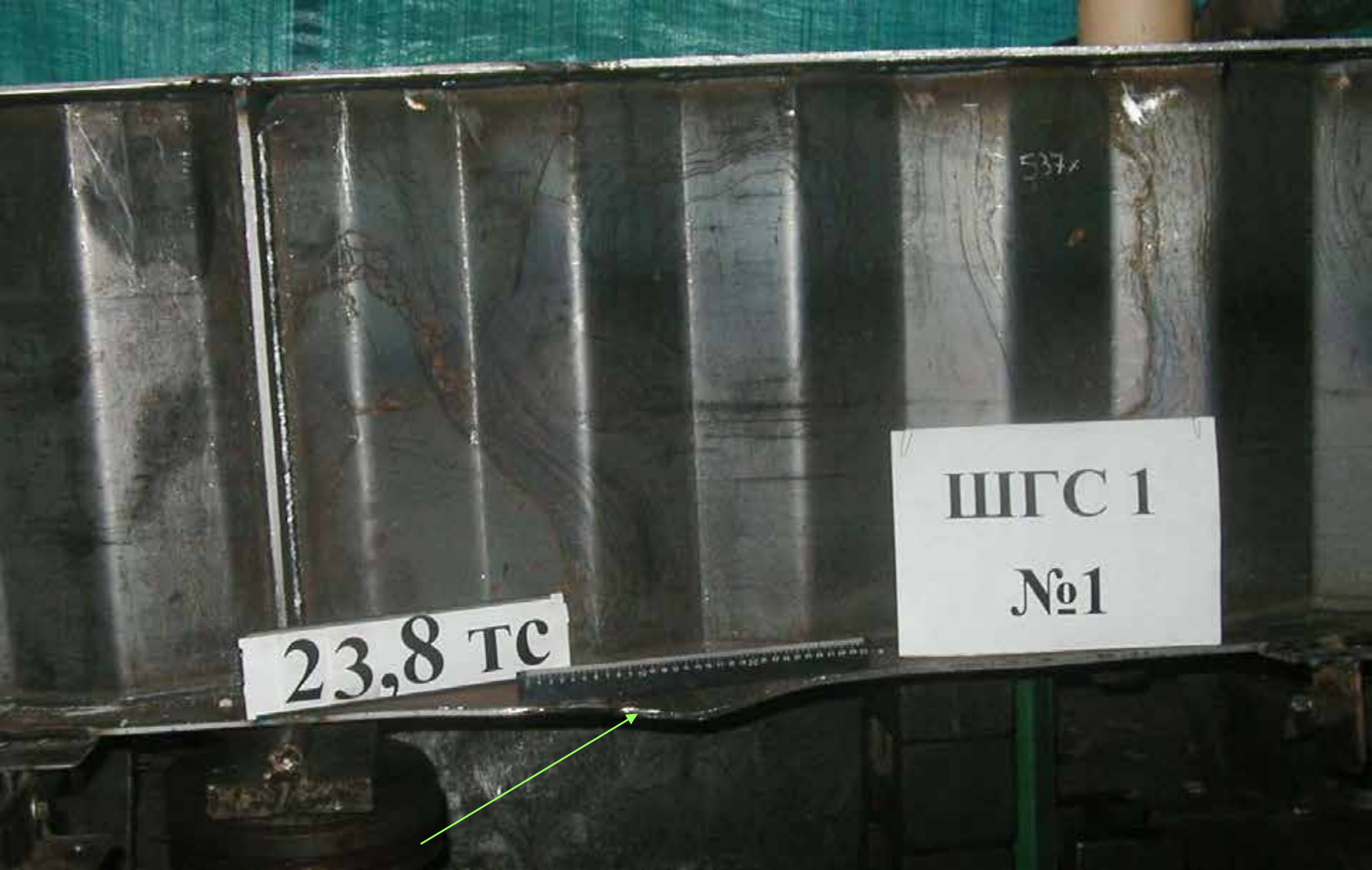
Потеря местной устойчивости сжатого пояса двутавровой балки с гофрированной стенкой
