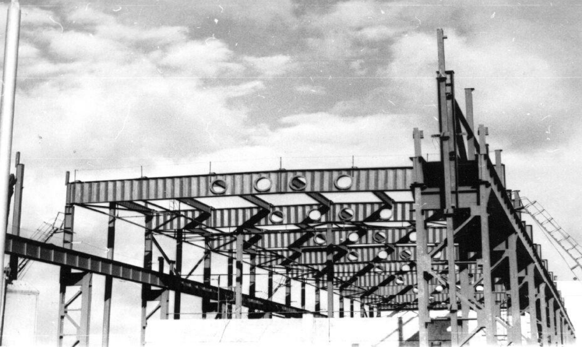
1985 год. Покрытие производственного корпуса в г. Заинск. Стропильная балка покрытия пролетом 24,0м. Высота балки 1400мм, толщина стенки 4,0 мм
