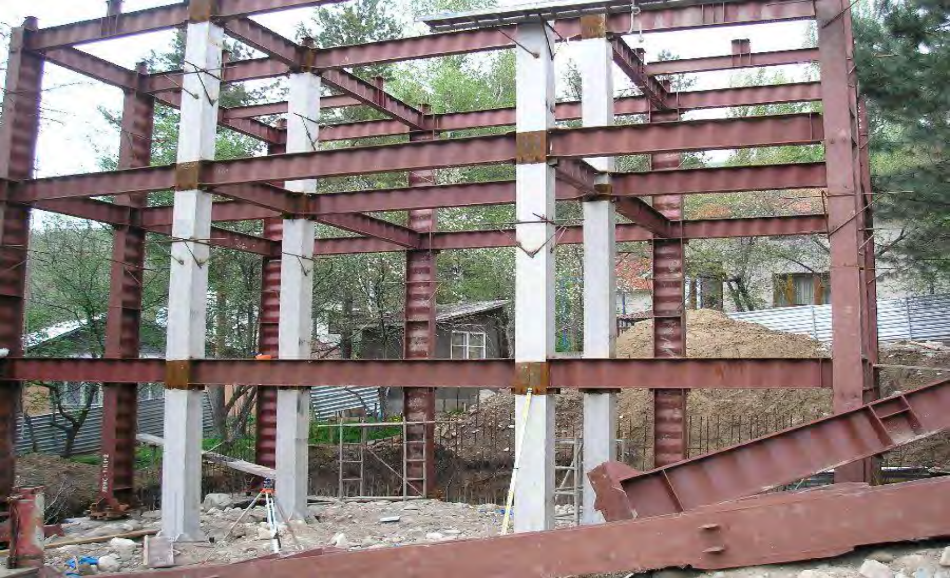
2007 год. Г. Алматы. Индивидуальный коттедж со стальным каркасом из двутавровых балок и колонн с гофрированными стенками
