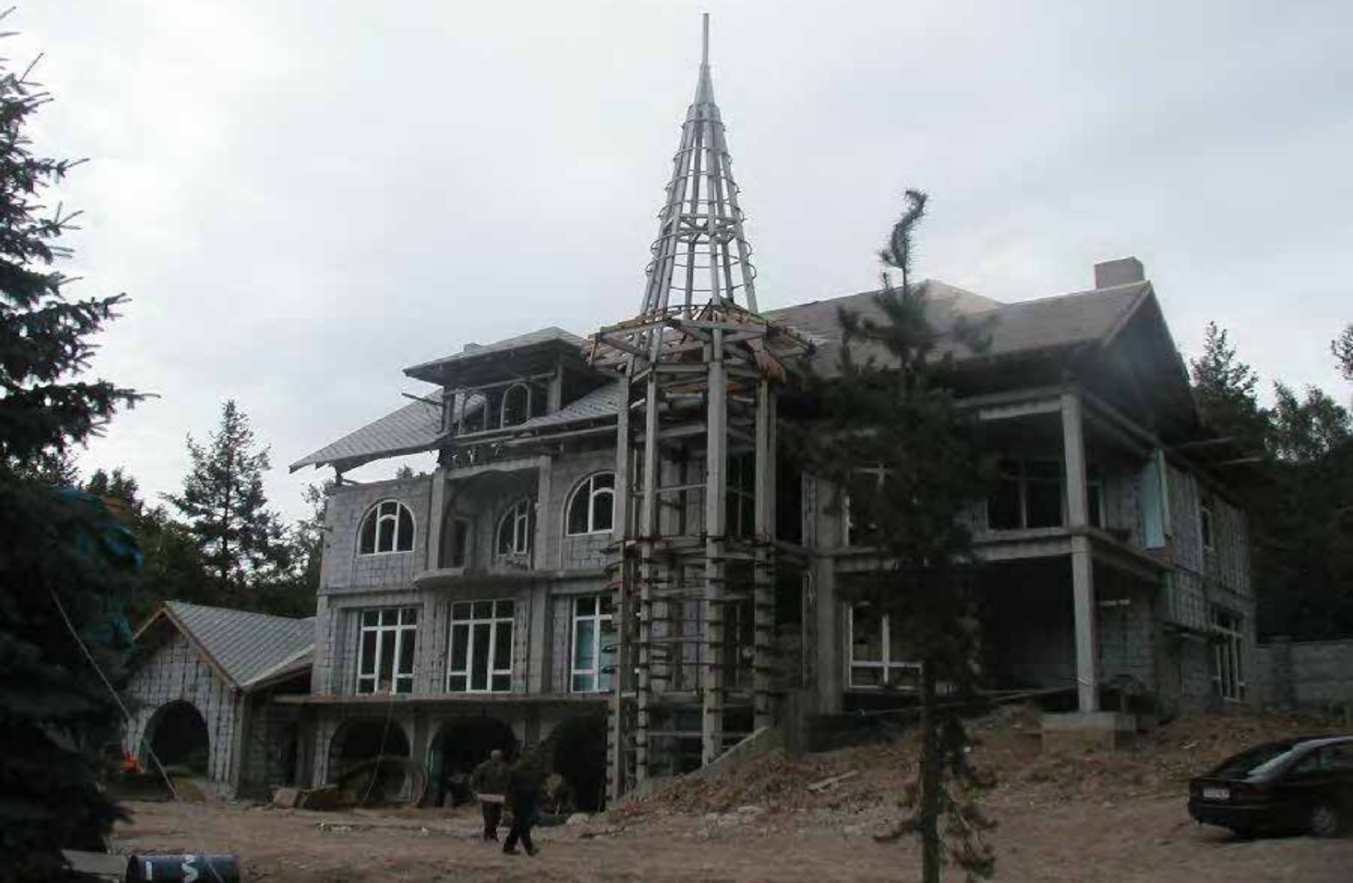
2006 год. Г. Алматы. Индивидуальный коттедж со стальным каркасом из двутавровых балок с гофрированными стенками
