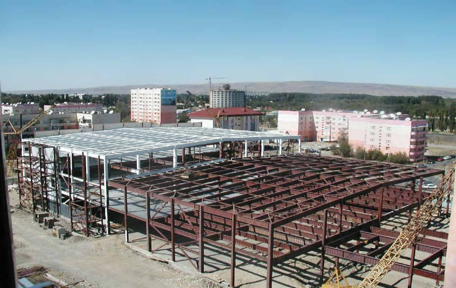
2007 год. г. Талдыкорган Алматинской области. Торгово-развлекательный центр «Сити Плюс». Основные несущие конструкции – колонны, ригели перекрытий и балки покрытий выполнены из сварных двутавров с гофрированными стенками
