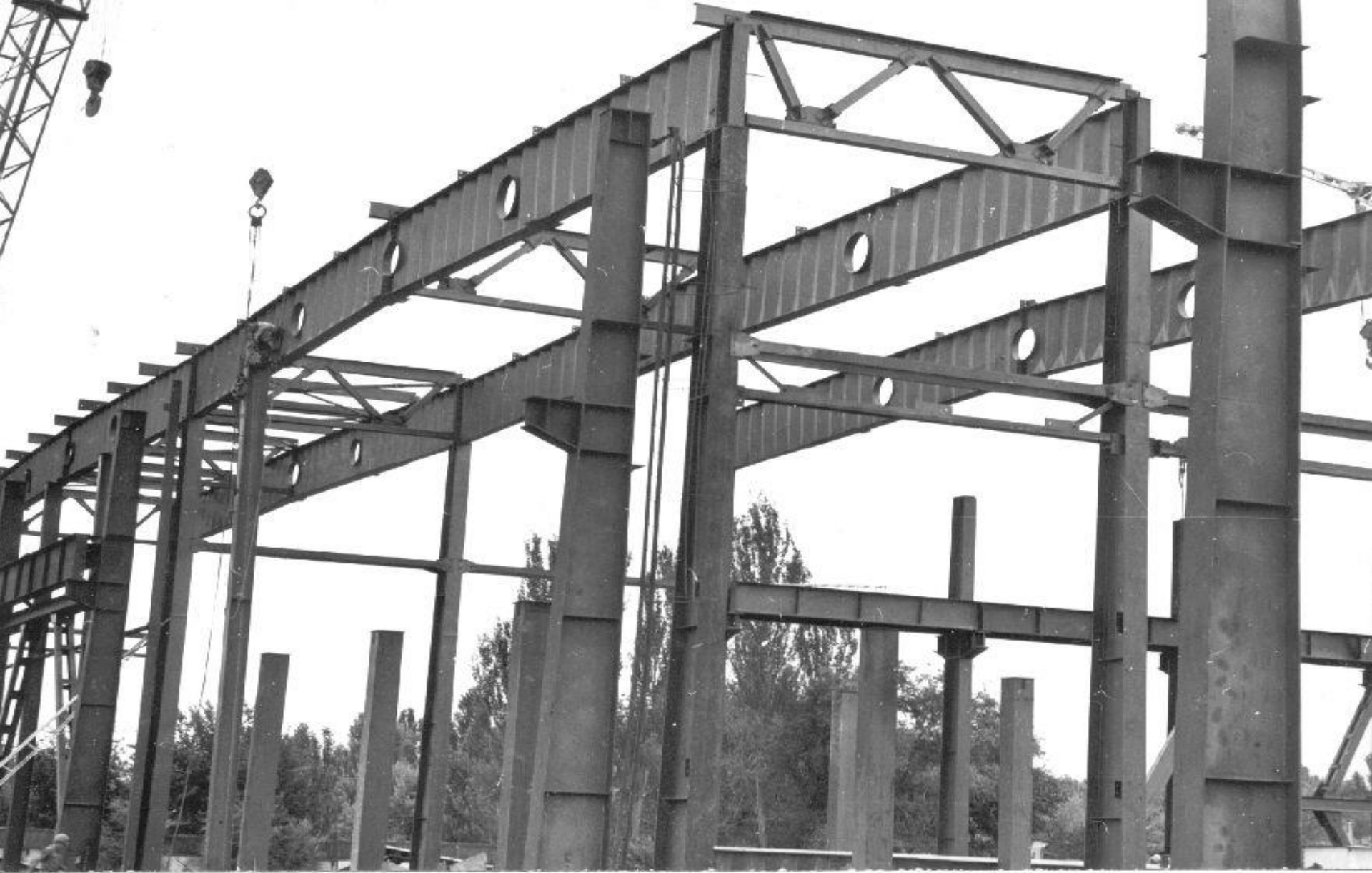
1982 год. Покрытие производственного корпуса в г. Алма-Ате. Стропильные балки пролетом 24,0м, высота 1400мм, толщина стенки 4,0мм
