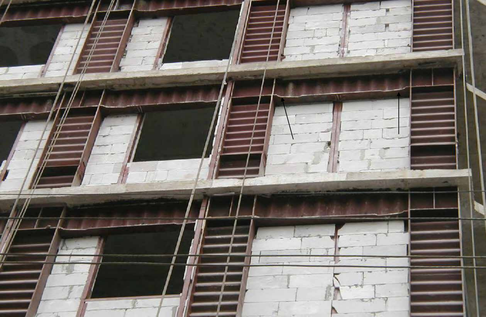
Фрагмент каркаса с колоннами и ригелями двутаврового сечения с гофрированными стенками. Стрелками показано на зоны равного сопротивления
